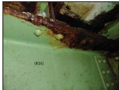
PIER 3 (B18) TOP FLANGE
