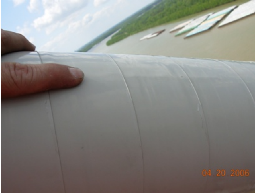
Longitudinal Split in PE
